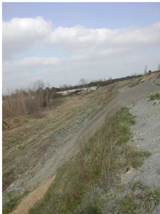
Photo n°2 : mise en place d'engrèvements sur le talus ouest et reprise du rampant
