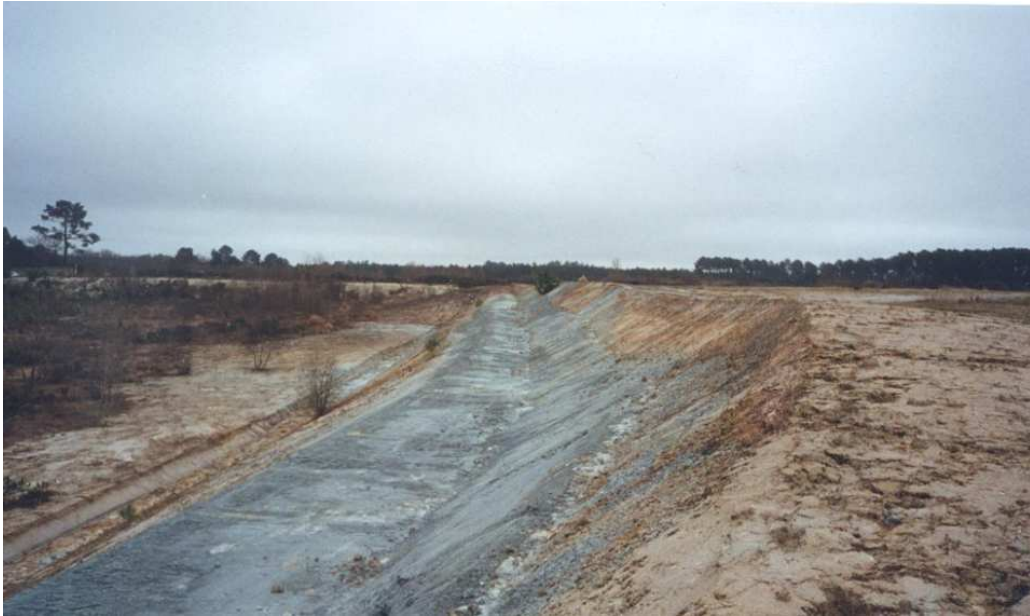
Photo n°1 : placage de carbonate de calcium sur le talus ouest
